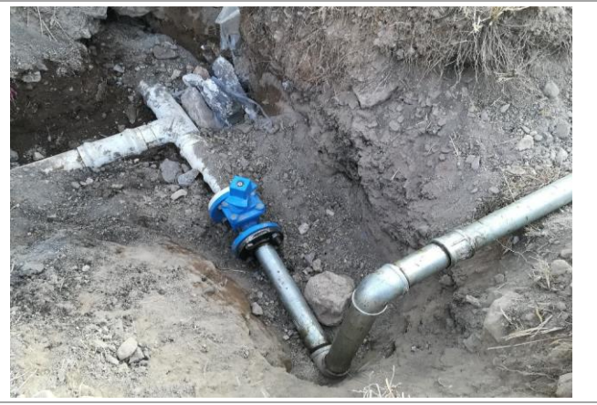
F4: Conexión de valvulas hacia cisterna
